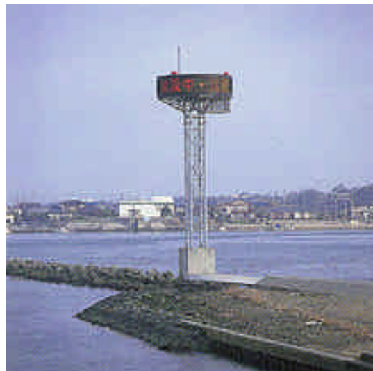
【津波警報装置】
