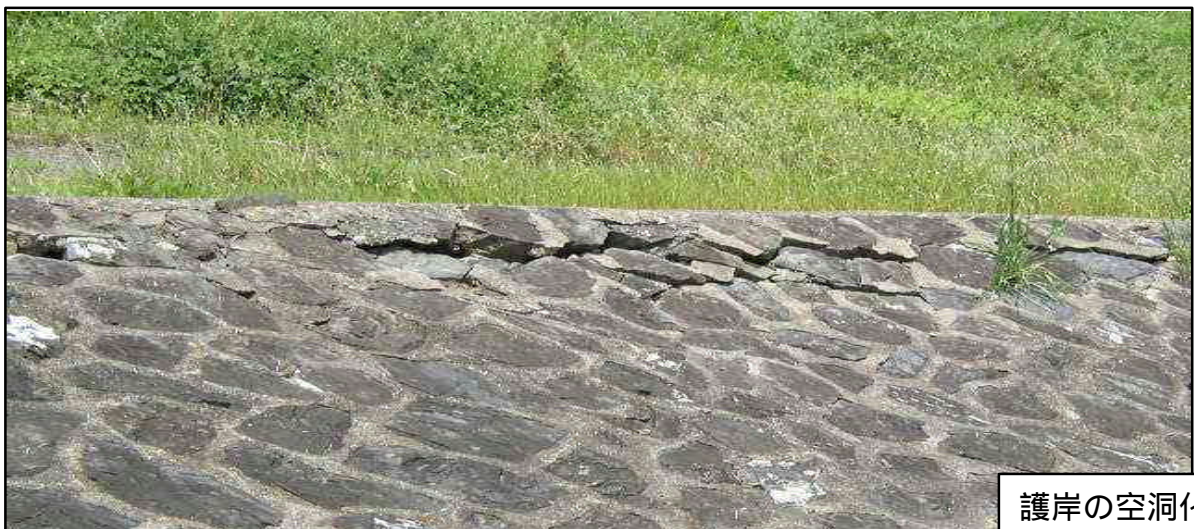
S56.8 小貝川高須堤防 決壊状況
