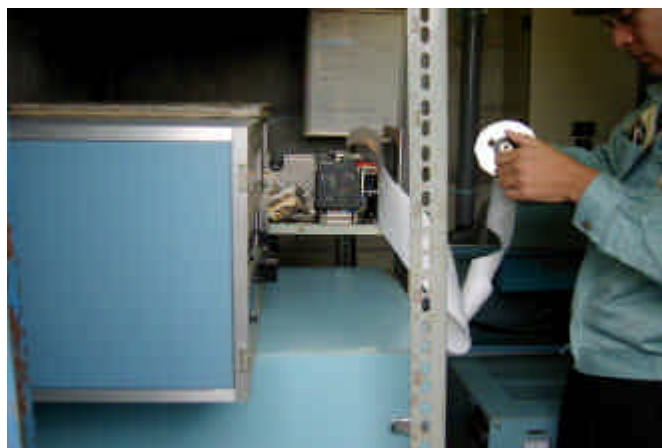
水位観測所内部 (自記紙の点検状況)
