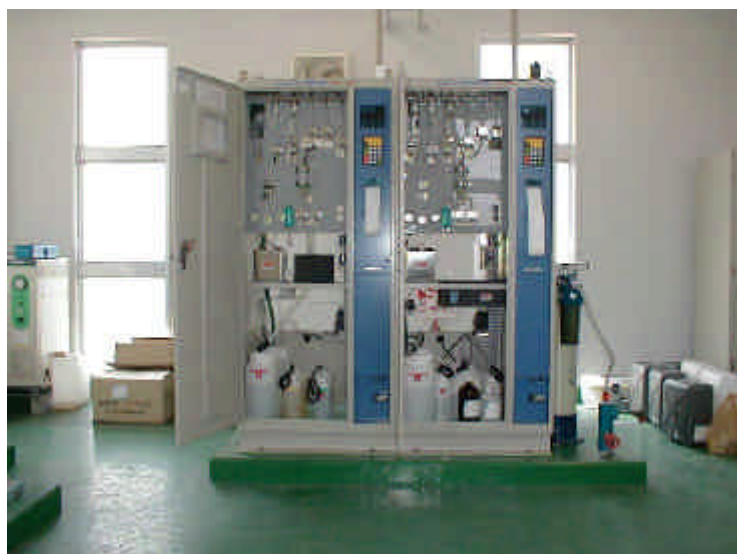
水質観測所内部
