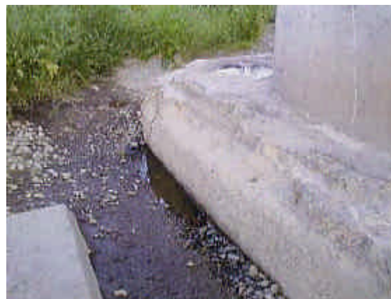
洗掘による橋脚基礎部の状況
