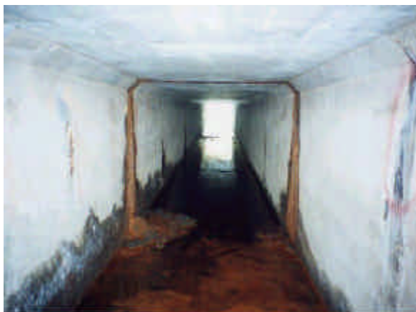
樋門内部のクラックによる土砂の流出状況
