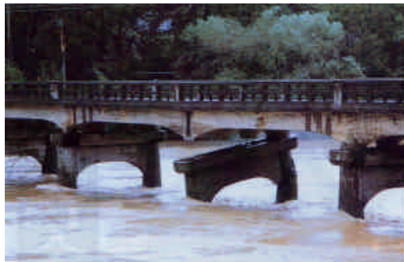
洪水により転倒した橋脚
