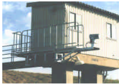
一体型高速巡回カメラ装置
