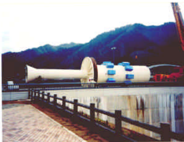
深層曝気設備の事例(設置前)
