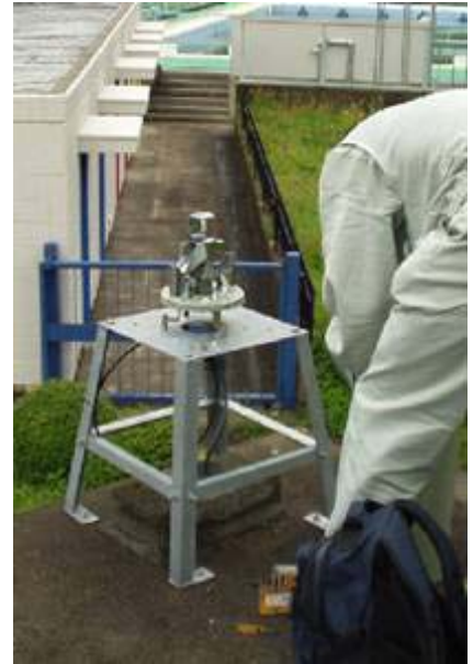
転倒ます型雨量計
