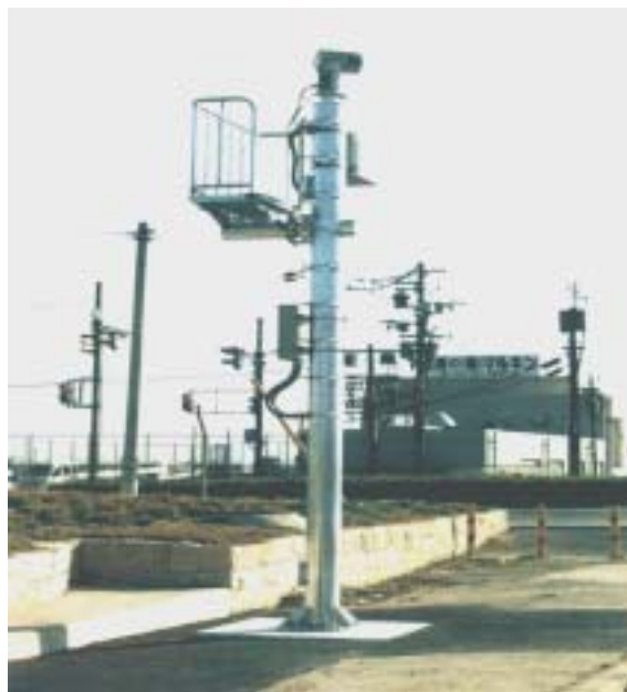
監視カメラ(CCTV)の設置状況
