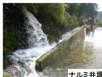
●用水路からの落水が魚道内の流況を乱している。
