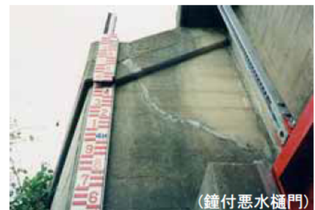
河川管理施設の被害状況
