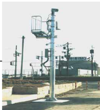
河川監視用カメラ装置
