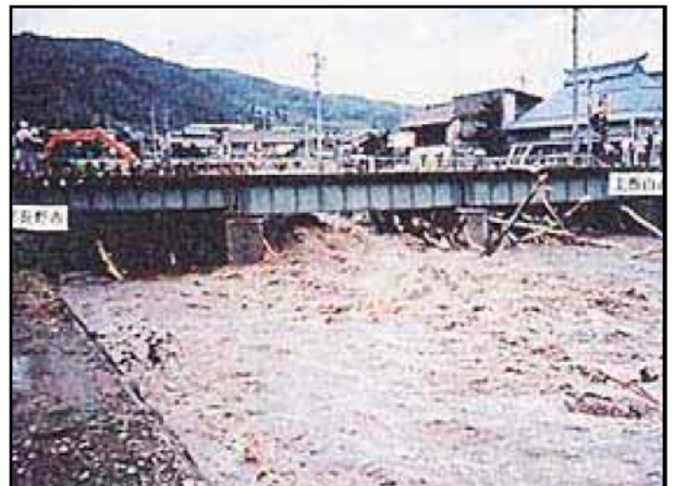
流木による橋脚部分の閉塞
