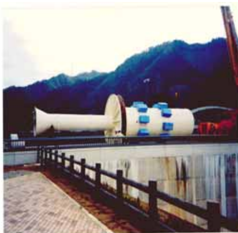
深層曝気設備(設置前)
