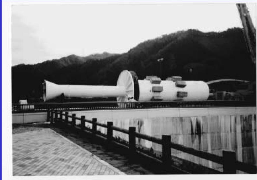
深層曝気設備(日吉ダムの事例)
