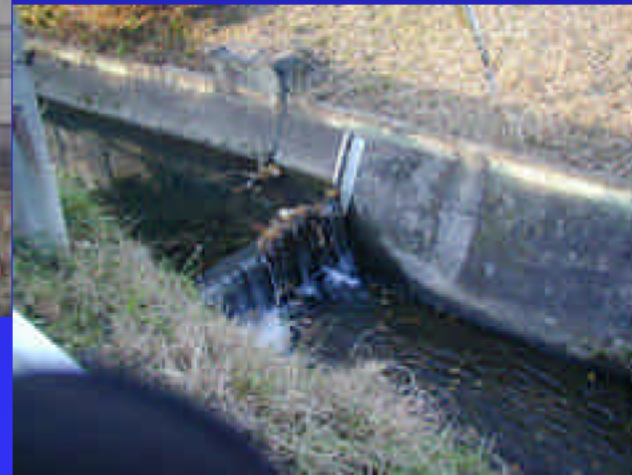
防火用水設備(盛越川)
