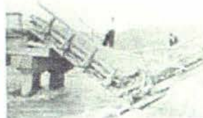
国友橋橋脚が沈下した様子 出典:私とあなたの琵琶湖アルバム
