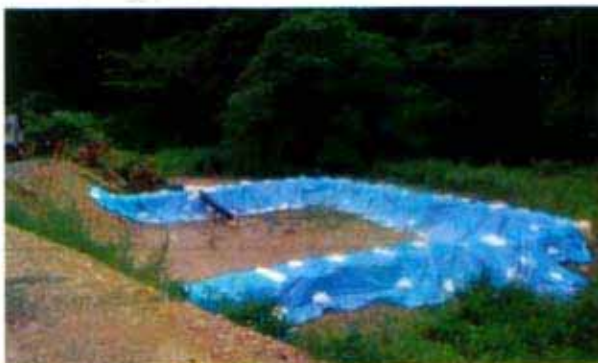
沈殿池（道路工事の濁水流出防止対策）
