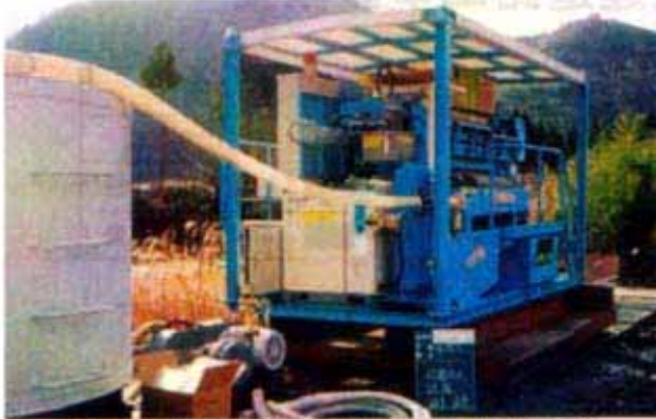
濁水処理施設（河川内工事の濁水対策）
