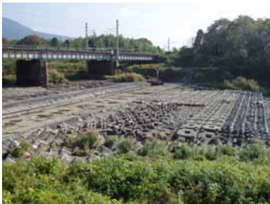
写真 H15.11.7、JR北陸本線直下 の落差工、瀬切れ発生状況
