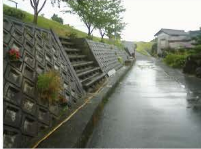
擁壁から湧水
