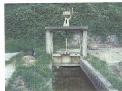
排水路止水ゲート
