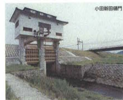
排水樋門の一例
