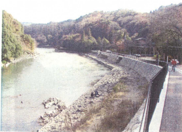
導水管敷設と道路拡幅で白川浜はコンクリートの下に。
