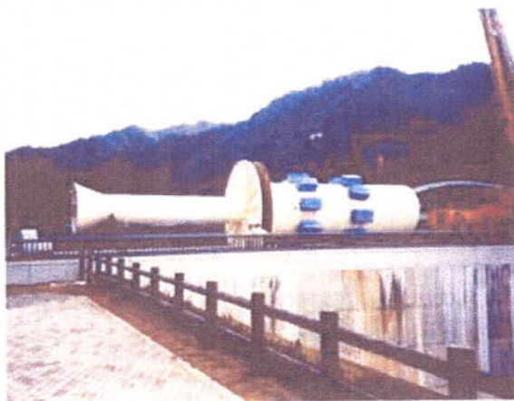
深層曝気設備の事例(設置前)
