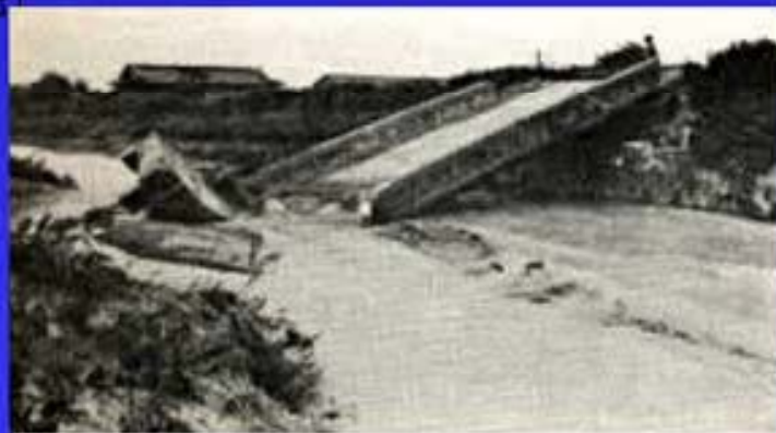
千里川 下走井橋被害状況
