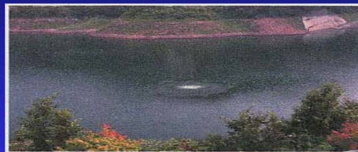
浅層曝気設備 (日吉ダムの事例)
