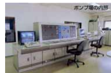
上野遊水池の集中管理室とポンプ場
