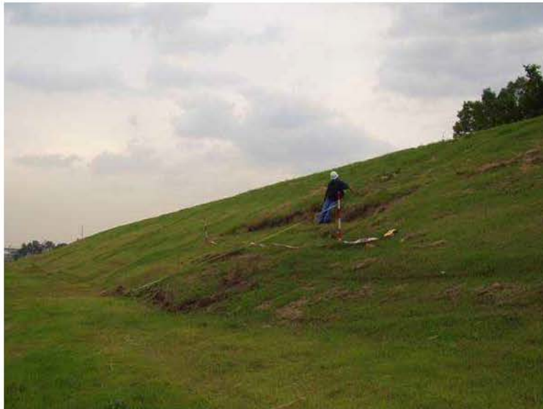
堤防法面の崩落
