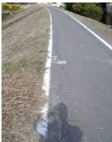
天端の亀裂状況
