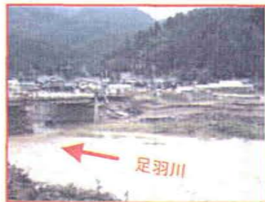
足羽川右岸堤防が護岸破損 （19日撮影）
