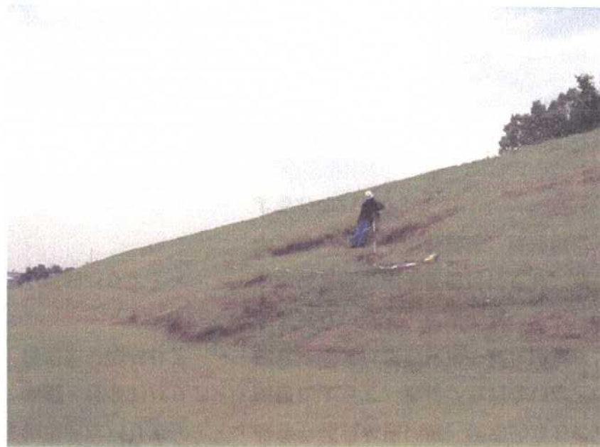
堤防法面の崩落
