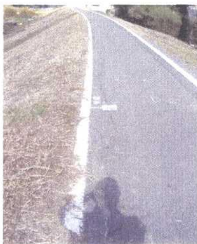
天端の亀裂状況
