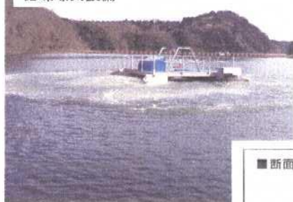
循環曝気設備
