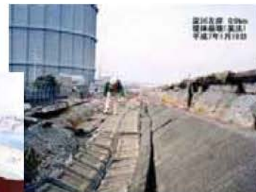
写真2 2 3 地震による護岸の倒壊
