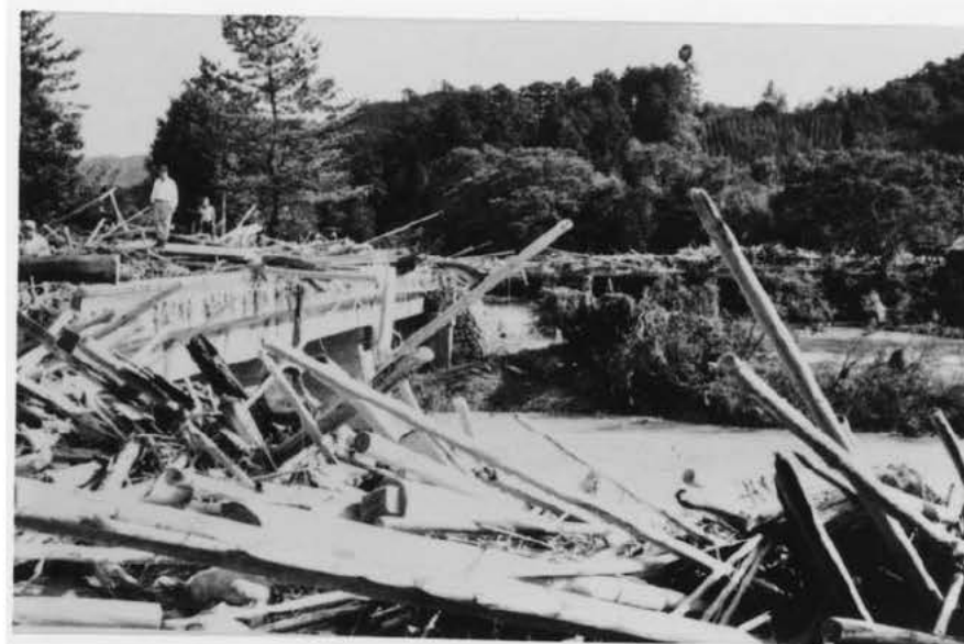
糸川橋の被災状況
