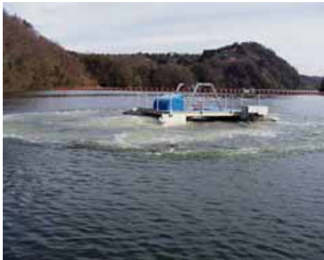
写真 4.2.4-3 循環曝気設備稼働状況
