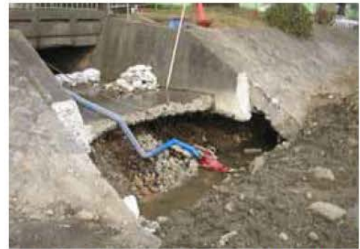
写真3.6-1 護岸空洞化の状況写真（平成19年1月に瀬田川で発見されたもの）
