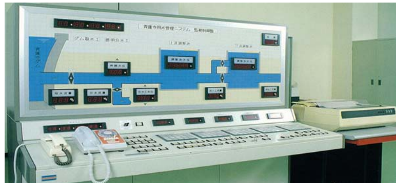
写真 4. 2. 4 青蓮寺用水管理システム監視制御盤
