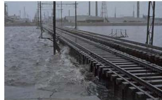
昭和36年9月 第2室戸台風時 高潮の状況 (阪神西大阪線)
