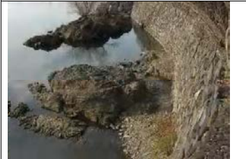
⑦ 工事後、流れが淀み、汚水の流入もあり、惨憺たる状況の亀石。
