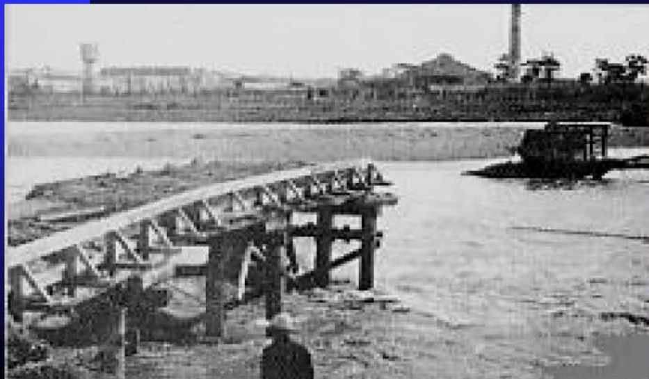
伊丹市桑津橋の流失状況
