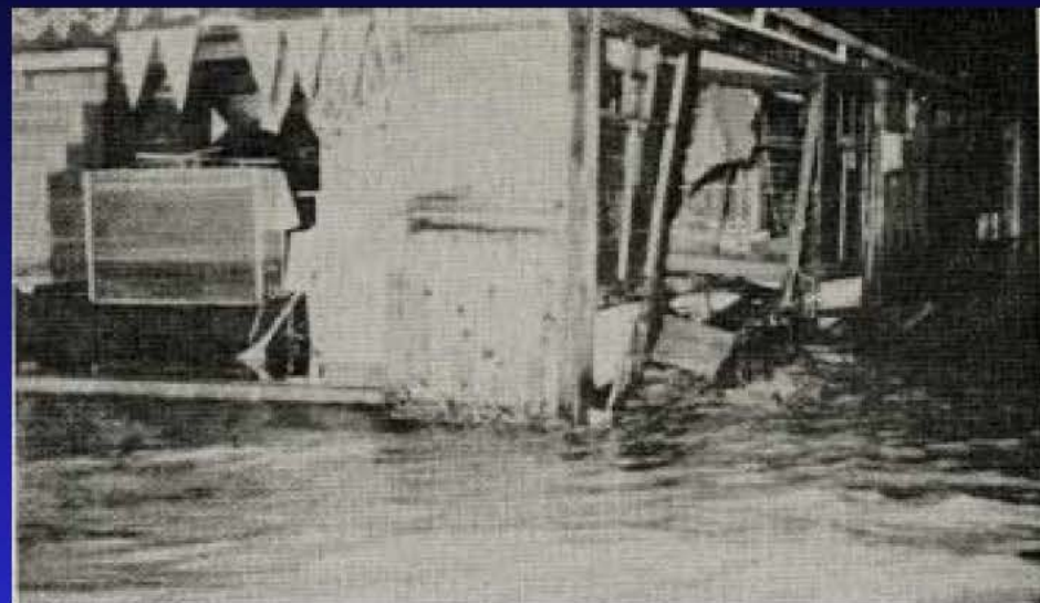
民家の被害状況(中の島)
