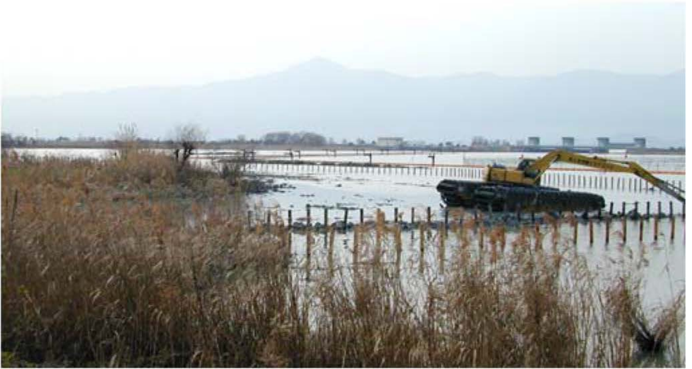
津田江の東北部の造成工事中。情緒のあった水辺が直線化される光景
