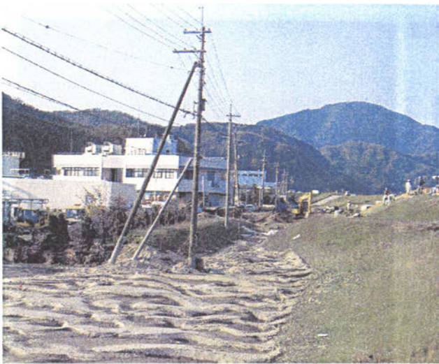
豊岡市一日市(堤防欠損箇所)
