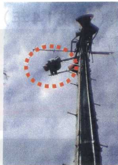
一庫ダム警報局舎(上垣内)へ添架 多田院左岸側
