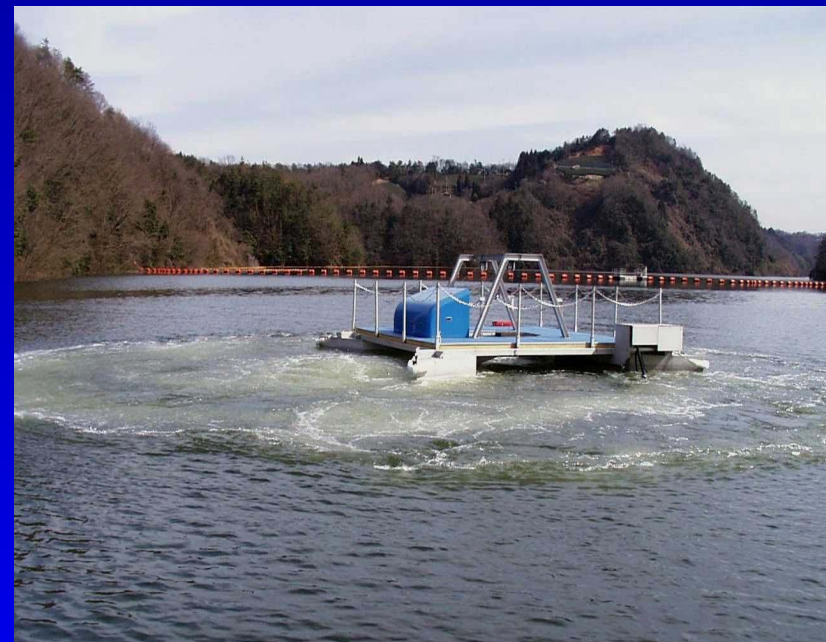
浅層曝気設備稼働状況
