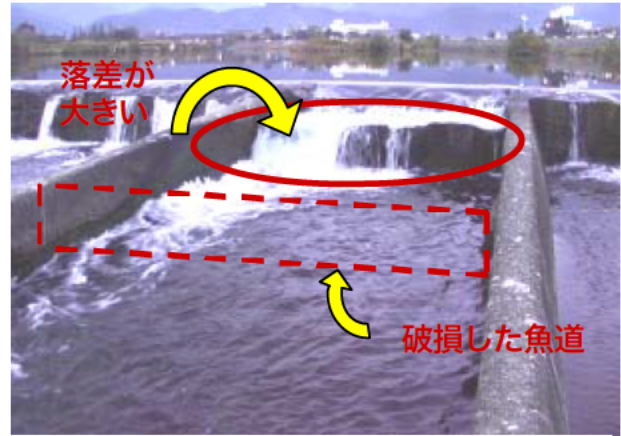
魚道が破損し、落差が大きい)
