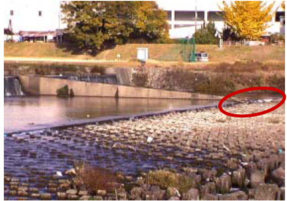
魚道下流に段差が生じている)
