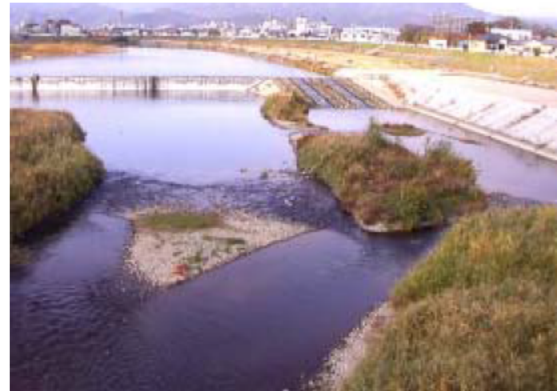
魚道下流の遡上経路が分かりにくい)
