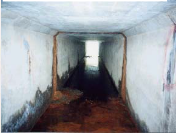
クラックからの土砂の流出状況
