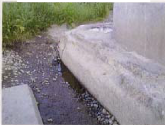
洗掘による橋脚基礎部の状況
