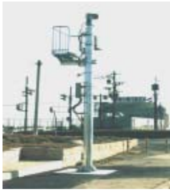
河川監視用カメラ装置
