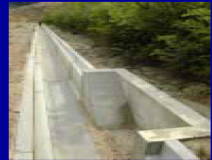
環境側溝 転落した小動物が這い出せる構造
