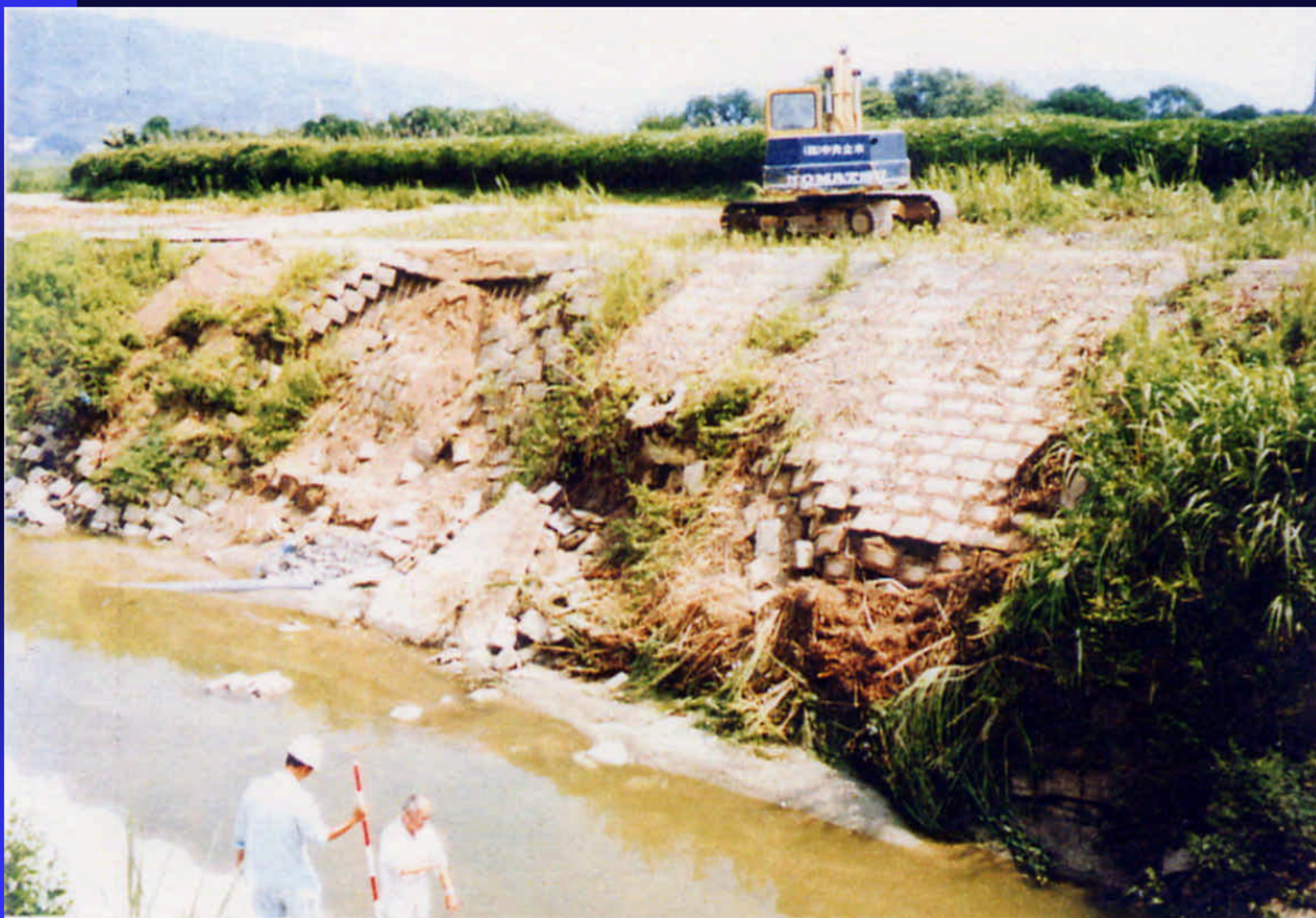
補修前の状況
