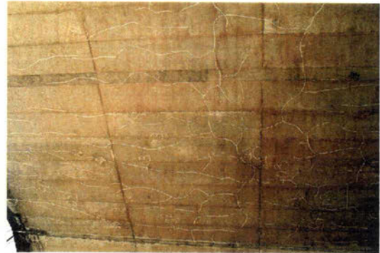
排水庭(淀川側)頂版下面の 進行性ひび割れ
