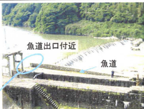
写真1 魚道の全景(相楽発電所取水堰)
