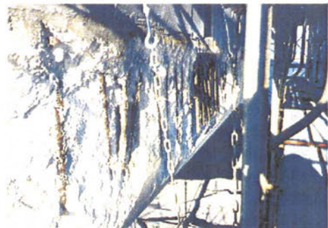
3号堰柱操作台の鉄筋腐食状況
