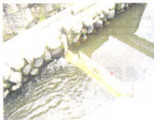
写真2 流量の調節(越流水深を設定)
