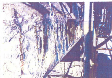
3号堰柱操作台の鉄筋腐食状況
