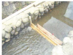
写真2 流量の調節(越流水深を設定)
