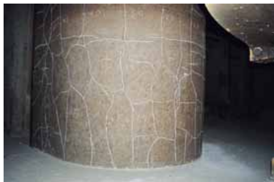
3号水路仕切壁の アルカリ骨材反応による劣化状況
