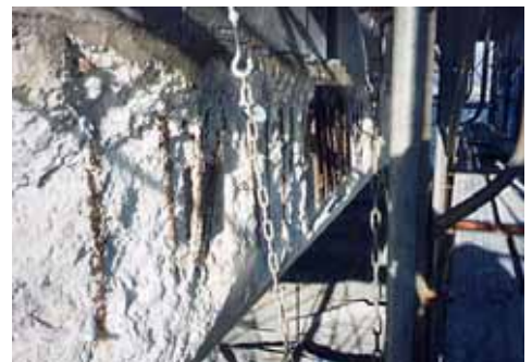
3号堰柱操作台の鉄筋腐食状況
