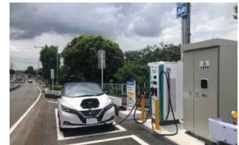
実験中の路上EV充電機器 (横浜市)
