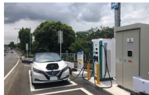
▲路上EV充電機器 (横浜市)
