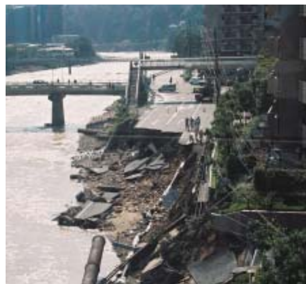
流失した旧国道176号
