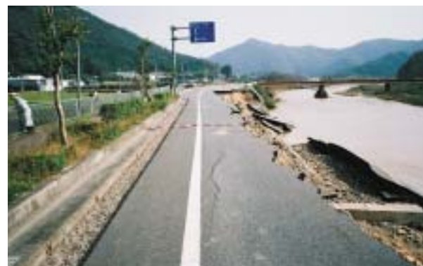
道路が流失した出石町の国道426号
