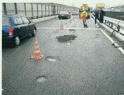
ポットホール補修前
